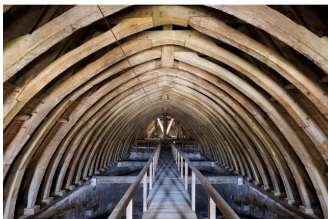
Cathédrale Saint-Corentin de Quimper, comble nord vu vers la croisée du transept © Pascal Lemaître / Ministère de la Culture / Centre des monuments nationaux / Médiathèque du patrimoine et de la photographie
